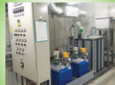
廃水処理システム 中和水槽
